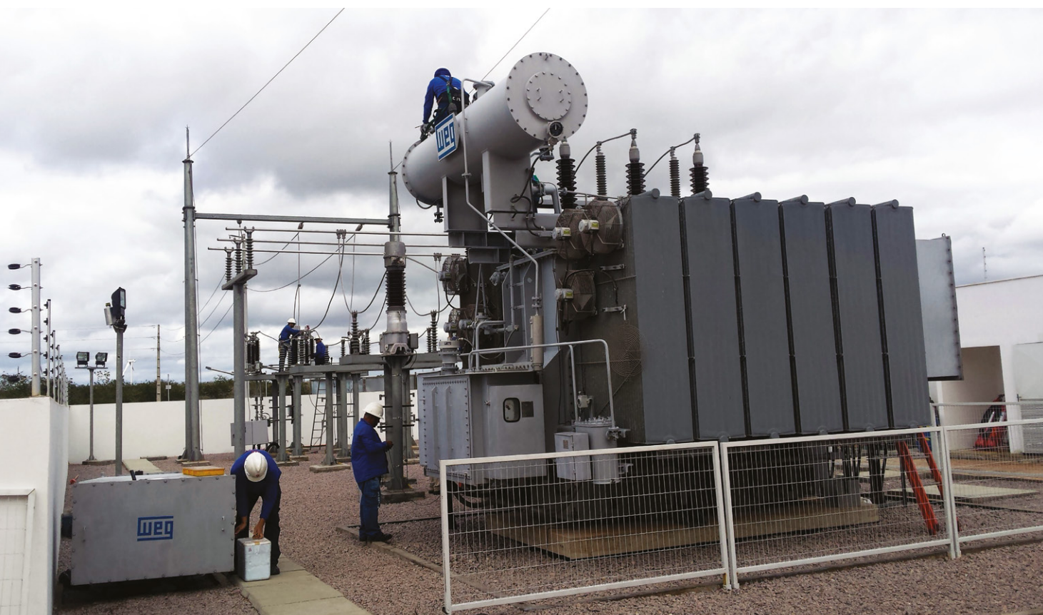
Fotos: Arquivo TRANFORTEC POWERING ENERGY
